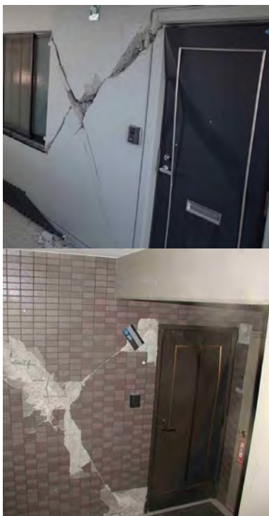
図4 非構造壁の被害
