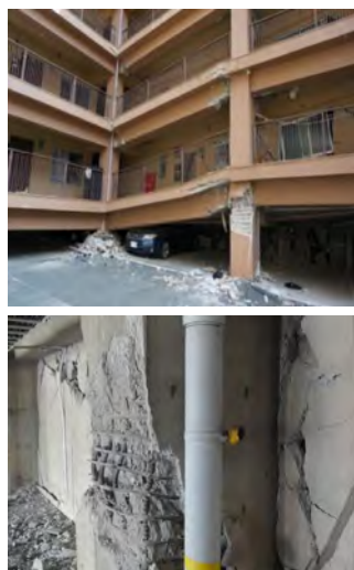
図3 躯体の地震被害
