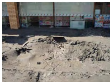
噴出泥土による歩行被害
