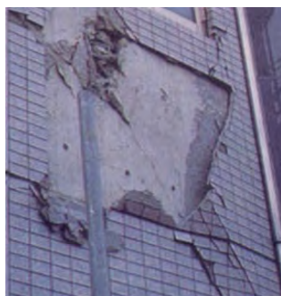
図5 外装タイルの被害
