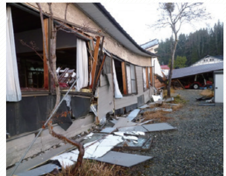
長野県神城断層地震の被害状況 (平成26年11月)
